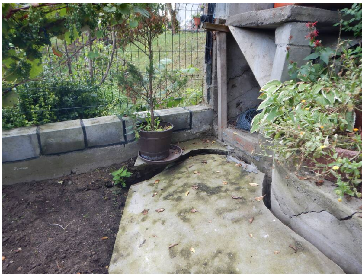
Fot. 4 Uszkodzony chodnik, ul. Wiśniowa 8 (Mianowski, 2022)
