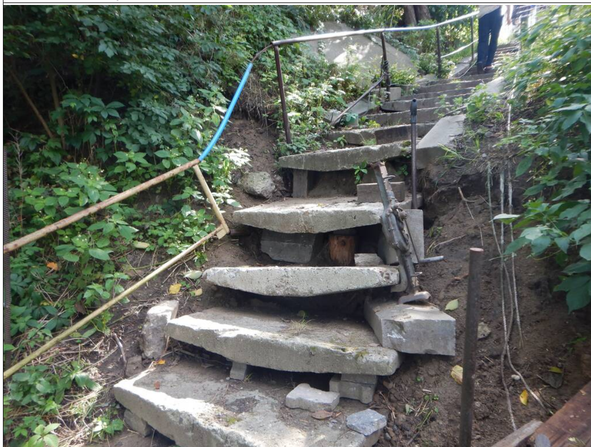
Fot. 7 Skarpa wtórna i uszkodzone schodki z betonowych płyt, ul. Toruńska 85 (Mianowski, 2022)
