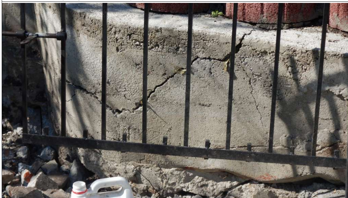
Uszkodzony betonowy murek w obrębie posesji (maj, 2023)
