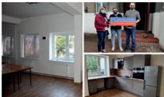
W budynku starej szkoły odzyskano na potrzeby świetlicy wiejskiej część pomieszczeń. Po gruntownym remoncie, modernizacji i doposażeniu służy teraz mieszkańcom
