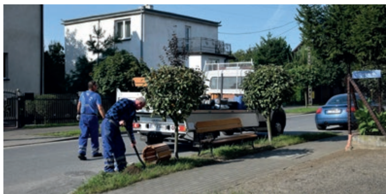
W wielu miejscach zamontowano ławki i kosze, pojawiły się nowe nasadzenia drzew
