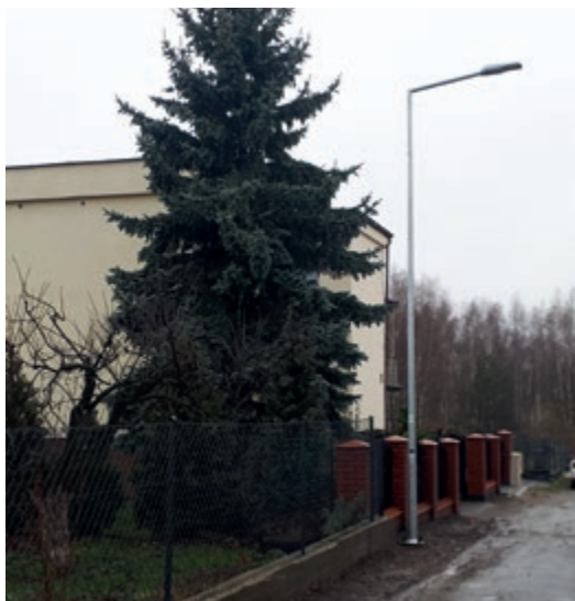
Budowa oświetlenia gminnego na ul.: Widokowej, Bocznej, Krótkiej, Owocowej, Makowej, Nowej oraz wymiana starych opraw sodowych na nowe ledowe
