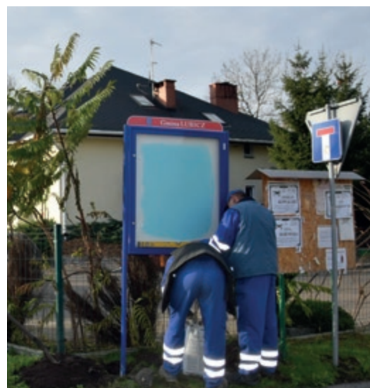
Nowa gablota i tablice ogłoszeń oraz przyłącze energetyczne na potrzeby imprez i wydarzeń organizowanych na placu przy ul. Owocowej
