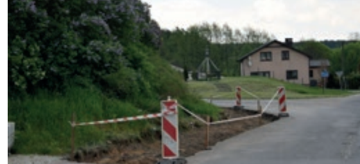
Remont tzw. parowy z budową chodnika przy ul. Gronowskiej, ul. Toruńskiej, z wyniesionym przejściem dla pieszych oraz barierkami ochronnymi
