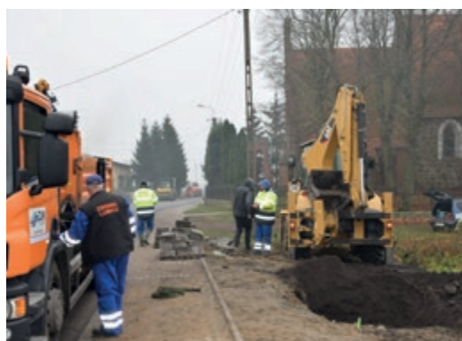
Odwodnienie przy kościele oraz dotacja prawie pół mln zł na remont elewacji kościoła
