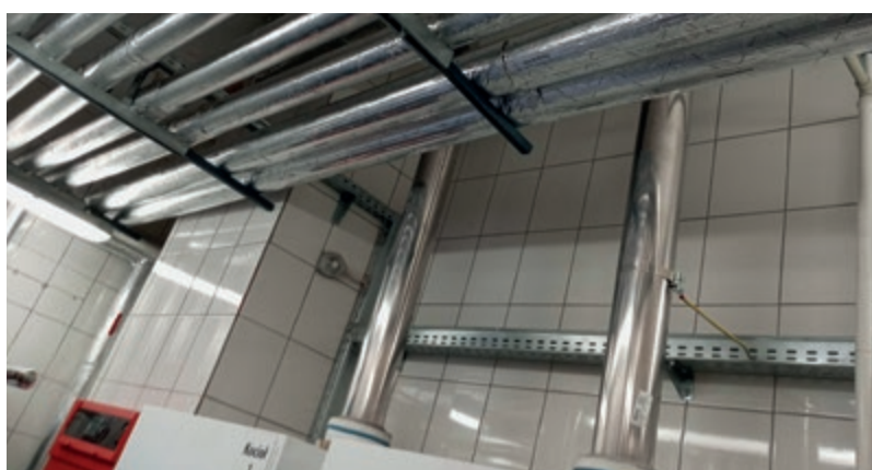
Nowy system ogrzewania dla starego budynku szkoły
