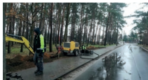
W Lubiczu Górnym stanęły nowe lampy uliczne, wymieniono oprawy na ledowe, a niedawno rozpoczął się montaż instalacji przy lasku na ul. Polnej
