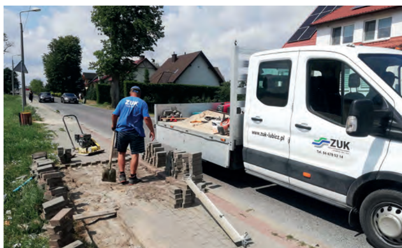
Naprawa chodnika w Gronowie zniszczonego przez TIR-y
