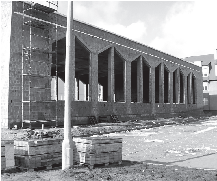
Trwa budowa pełnowymiarowej sali gimnastycznej przy Zespole Szkół Nr 1 w Lubiczu Górnym. Zakończenie budowy 31 sierpnia 2006r.
